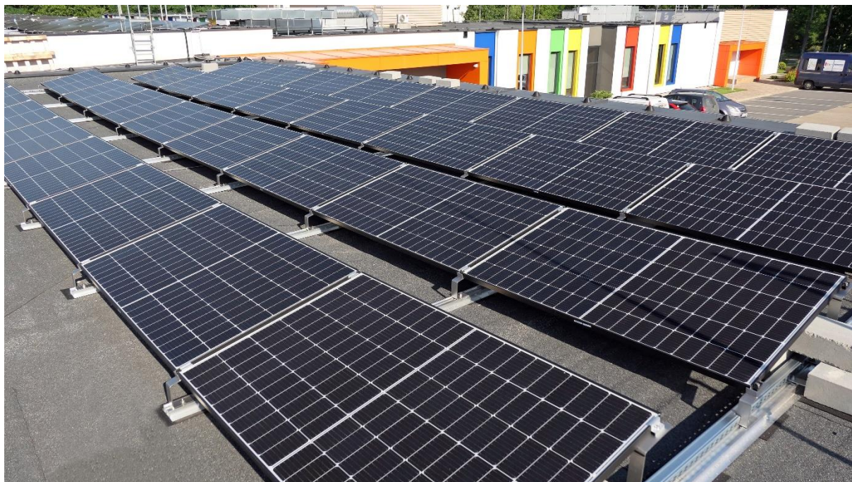
Fot. 7. Dofinansowana przez WFOŚiGW w Łodzi mikroinstalacja fotowoltaiczna na potrzeby Hospicjum prowadzonego przez Stowarzyszenie „Łódzkie Hospicjum dla Dzieci – ŁUPKOWA”.
